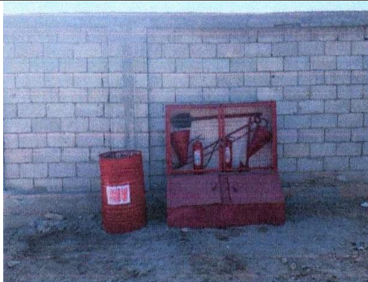
Рисунок 17. Противопожарное оборудование на ТПС Хаккулабад
